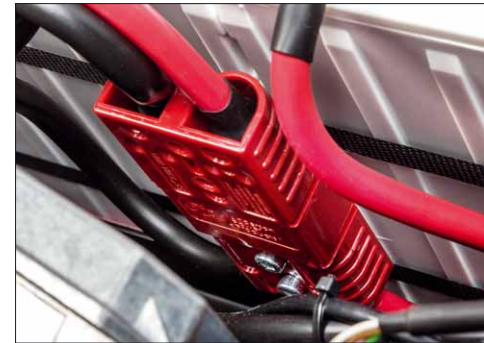
Das ist mal ein Stecker: Der Akkupack ist im Gerät über einen sogenannten Anderson-Verbinder angestöpselt
